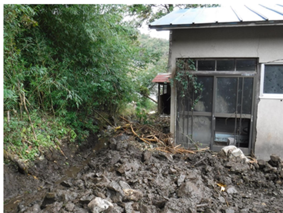
流出した土石が家屋まで到達し、家屋の一部が埋塞している
